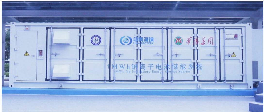
图表 43: 1MWh 钠离子电池储能系统
