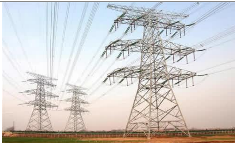
图 17：1000kV 晋东南-南阳-荆门特高压交流示范工程
