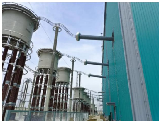
图47: 公司直流穿墙套管应用于白鹤滩-江苏直流工程
