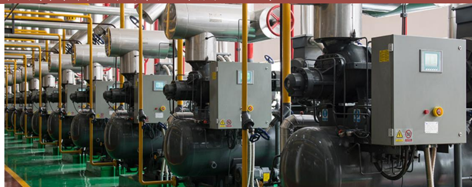
图20.威海海都食品集团有限公司制冷项目机房
