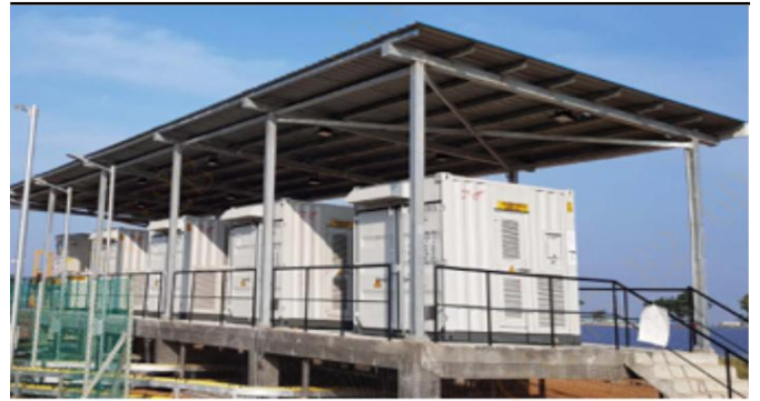
图表 23. 集中式逆变器专用机房
